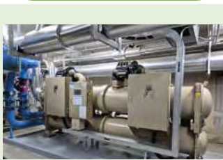
汰換門診大樓 變頻磁浮離心式主機
